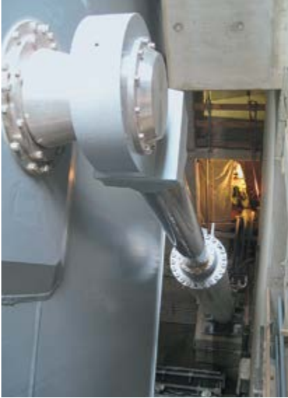
Einer der zwei Hydraulikzylinder, die für den Hebevorgang der Klappbrücke sorgen. Foto: Günter Alvensleben
